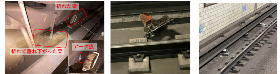
損傷した集電装置とアーク痕 脱落した集電靴 損傷した碼子
